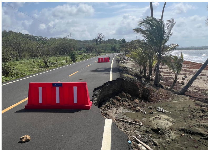
En Palmas Bellas en el 2010 más de 22 casas sufrieron daños debido a la erosión costera. Foto: cortesía Eric Chichaco
