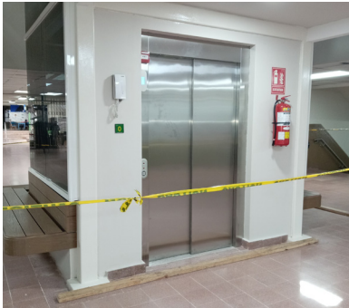
Castillo indica que pronto se estará inaugurando el nuevo ascensor de la torre.
